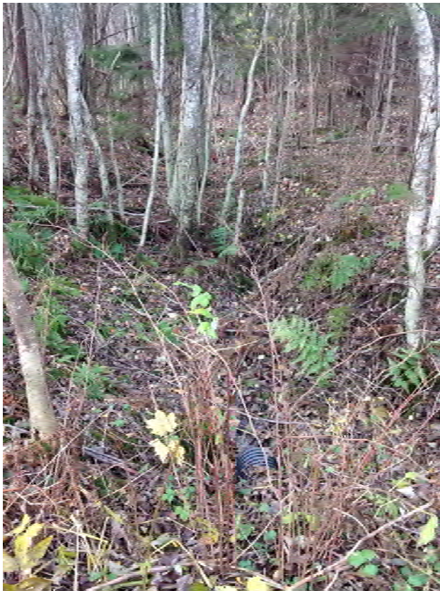
Figur A3: Stikkrenne under traktorvei i D1. Med store mengder vann kan erosjon utvikle seg
