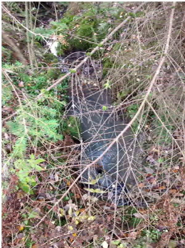
Figur A2: Stikkrenne under traktorvei i D1. Ved store mengder vann kan erosjon utvikle seg
